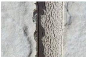
細かなひび割れ
