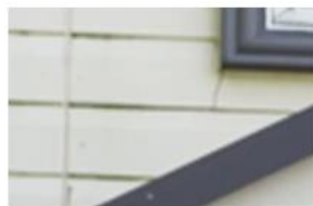
サッシ下の割れ
