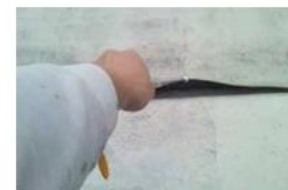
防水層のめくれ
