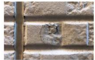
釘周りの割れ
